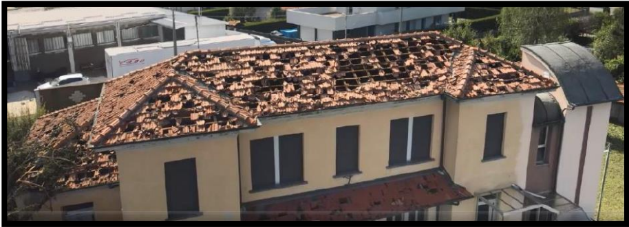
Figura 4: Ingenti danni alle coperture di edifici pubblici e privati in comune di Misinto. Fonte Regione Lombardia.
